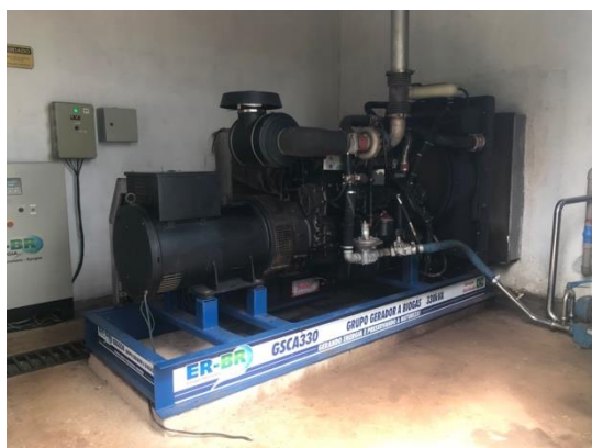
Figura 18 - Grupo gerador a biogás
